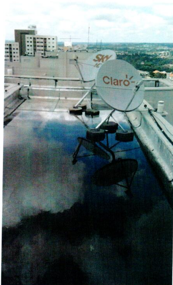
Figura 1 – Acúmulo de águas de chuvas sobre laje de reservatório elevado (Bloco D)
