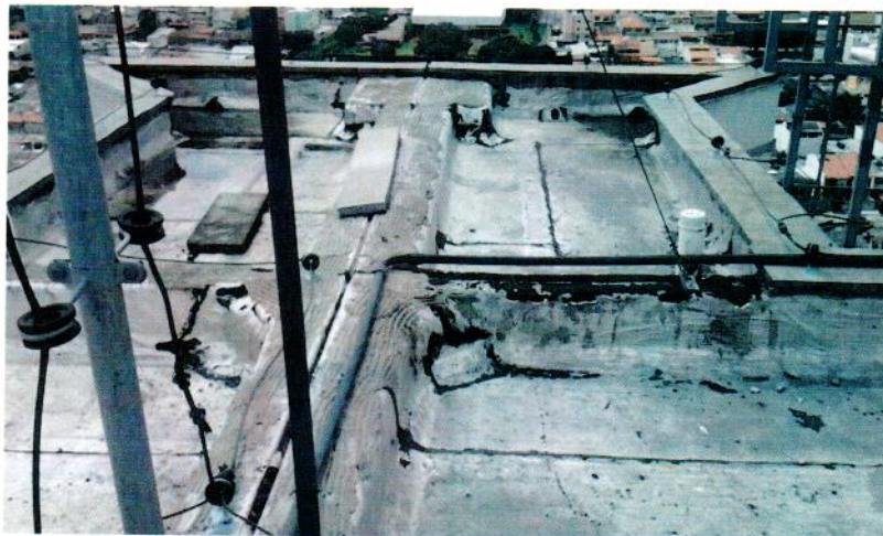
Figura 13 – Material solto sobre manta da laje e rufo avariado (Bloco A)
