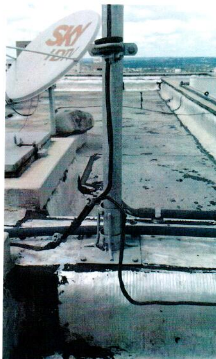
Figura 9 – Instalação inadequada de base do para-raio Franklin sobre manta (Bloco C)
