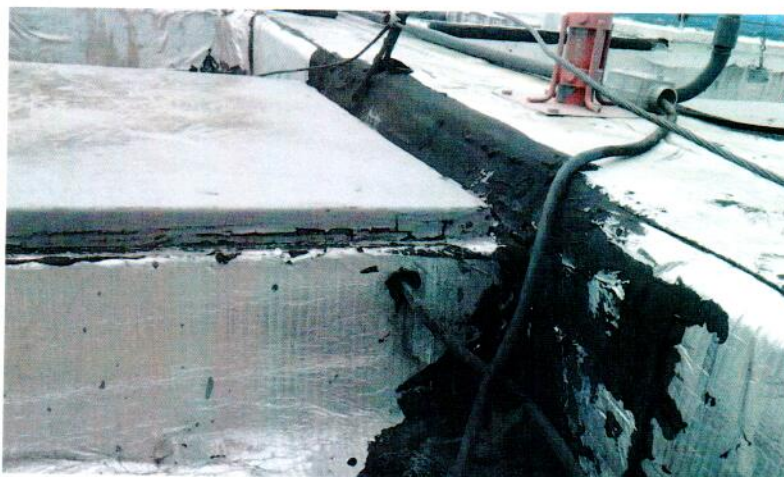
Figura 11 – Perfuração em manta para passagem de cabo elétrico do automático de boia (Bloco B)
