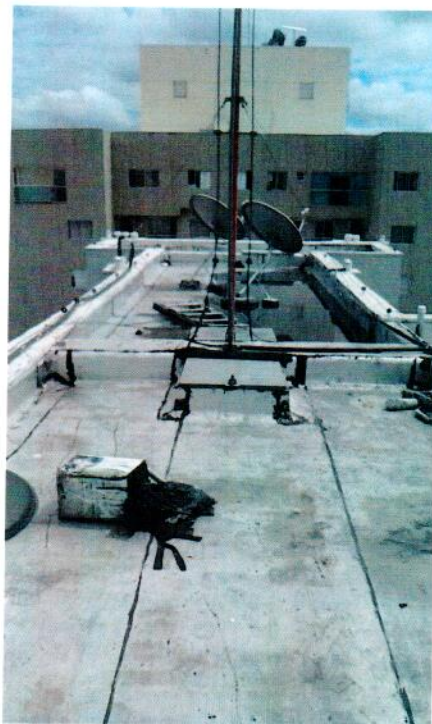
Figura 10 – Laje de tampa do reservatório superior com ferramentas a remover (Bloco B)
