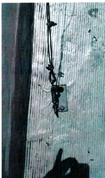
Figura 7 – Fixação inadequada de estal de cabo do para-raio tipo Franklin (Bloco D)
